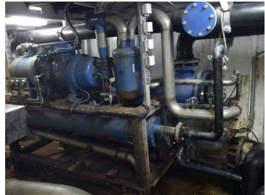
Bilde 3: Kuldeanlegg i et av fartøyene
